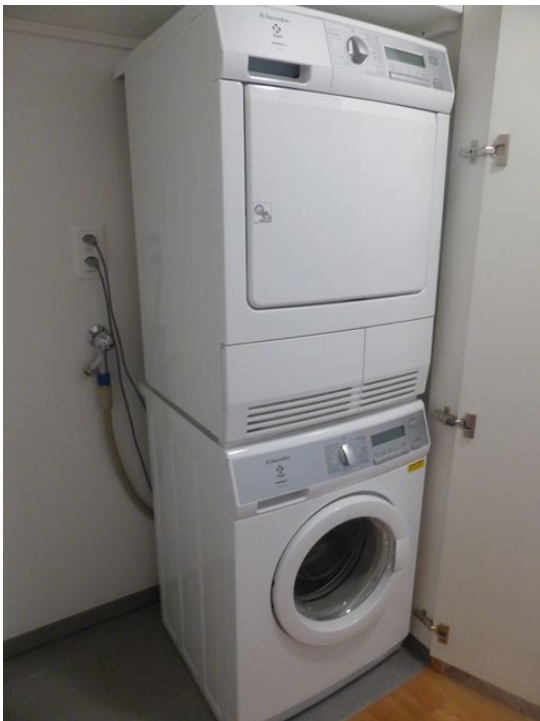
Abb. 08 : WA/TB im Einbauschränk
