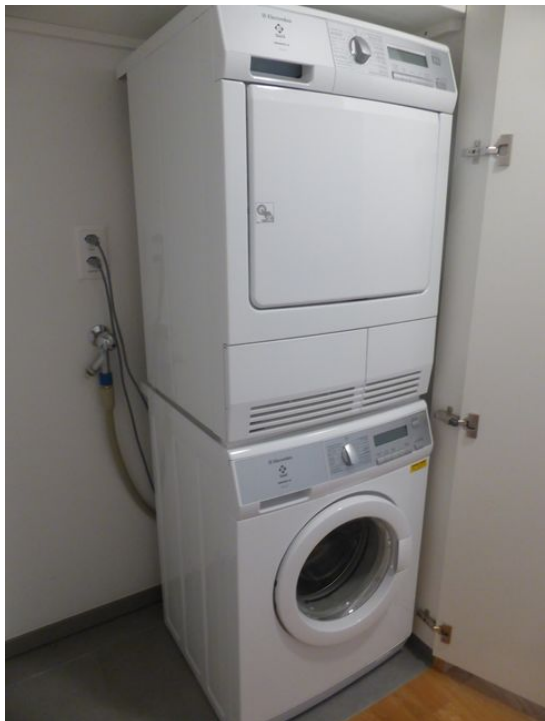
Abb. 09 : WA/TB im Einbauschränk
