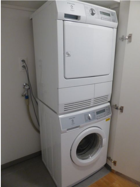
Abb. 07 : WA/TB im Einbauschränk
